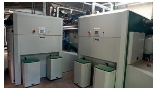
Centros de biomasa de Red Centralizada en Complejo de Presidencia de la Junta de Castilla y León (Valladolid)
