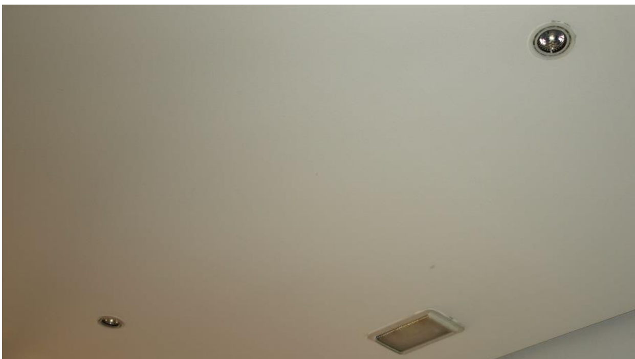
FOTO 1: Antiguas luminarias halógenas
