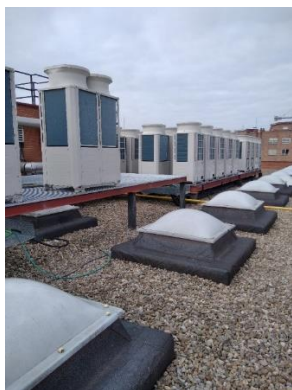
Nuevas bombas de calor (aerotermia)
